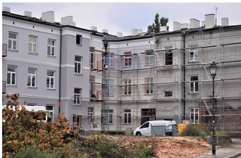
Fot. 16. Budynek przy ul. Brzeskiej 23 w trakcie remontu w ramach projektu pn. Dotacje do remontów (źródło Wydział Rewitalizacji UM Włocławek)
